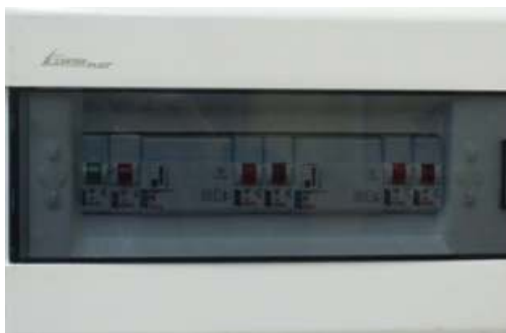
Rys. 3. Widok rozdzielnicy z lampkami sygnalizującymi stany wyjść przekaźnika
